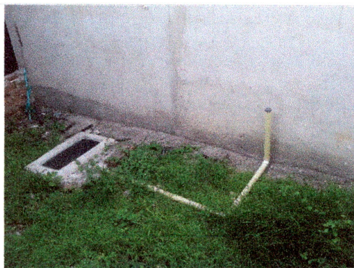
Trampa De grasas centro La Victoria
