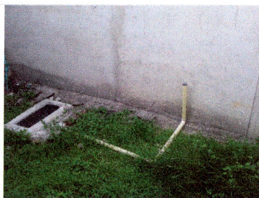
Trampa De grasas centro La Victoria
