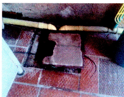
Trampa de grasas lavandería
