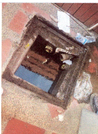
Trampa de grasas que intercepta las aguas procedentes del star de enfermería
